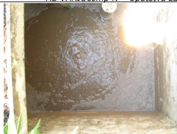
Površina dela za aeraciju
